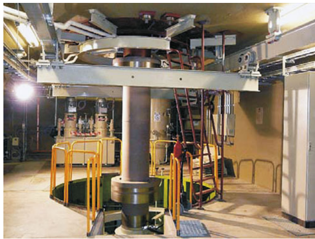
Рис. 12. ГЭС Лос-Караколес: промежуточный вал и механизм для демонтажа рабочего колеса гидротурбины
