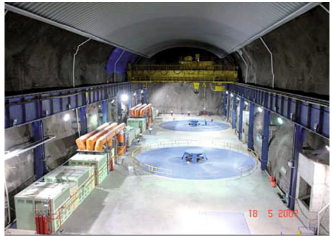
Рис. 11. Машинный зал подземного здания ГЭС Эль Кахон
